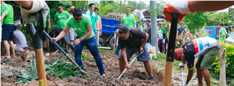
Lexmarkers installa il sistema di raccolta dell'acqua piovana di Gawad Kalinga Cebu, Philippines
